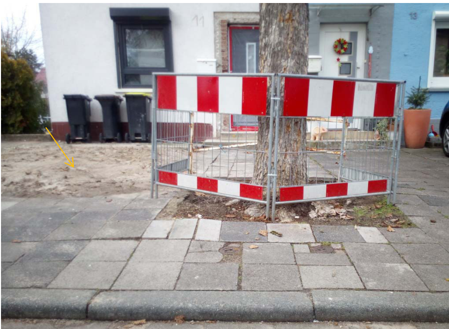
Zwei Wasserschieber im bereits angehobenen Pflasterbelag des Gehwegs, Baumwurzel auf den Bildern jeweils mit orangem Pfeil markiert
